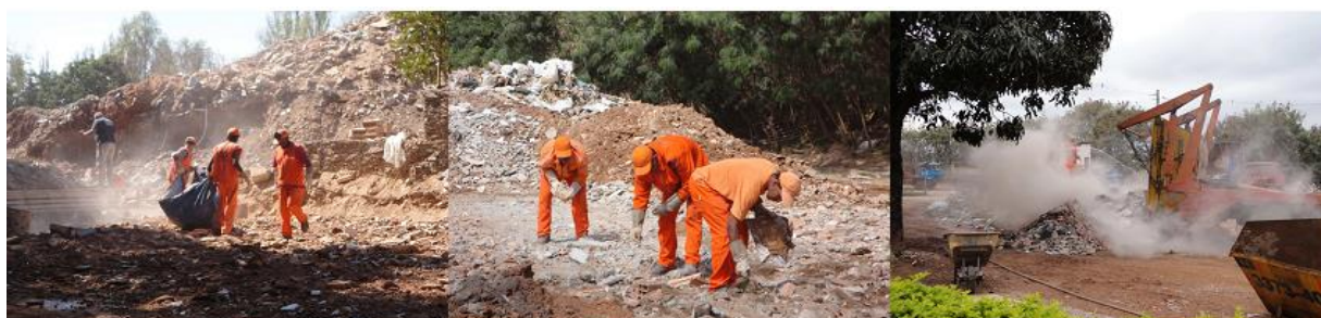
Figura 3 - Situações de riscos durante a triagem dos resíduos nas Ars
