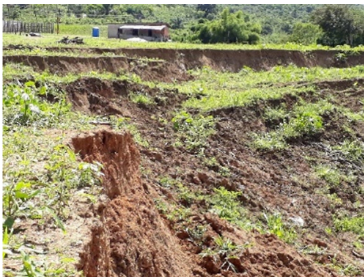
Figura 7. Aterro rompido sobre tubulação de petróleo nas imediações da Estação Marapé. Essa imagem situa-se no “local de vazamento” referenciado na Figura 8. A fotografia foi tirada em 19 de maio de 2018.
