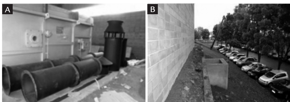
Figura 10 Forno horizontal da EESC/USP: (A) Tubulação metálica de exaustão. (B) Duto externo de alvenaria para saída da chaminé metálica.
