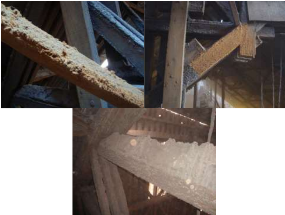
Figura 4 - Acúmulo de material químico na superfície dos elementos estruturais
