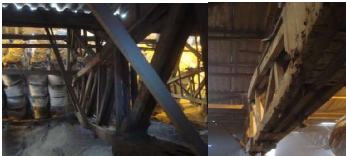
Figura 7 - Flambagem de treliças por deficiência no travamento
