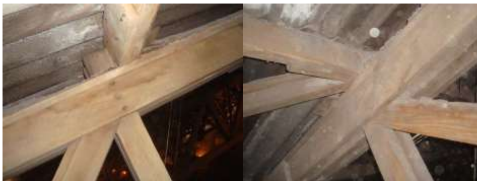
Figura 3 - Pontos de umidade na estrutura de cobertura
