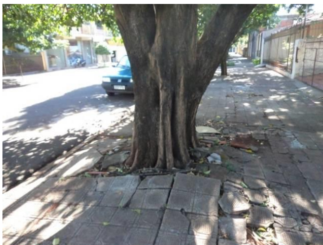
Figura 10- Calçada danificada pelas raízes na Rua Benjamin Constant - Zona 7
