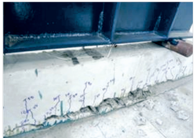
D Configuração da viga VA-4 na ruína
