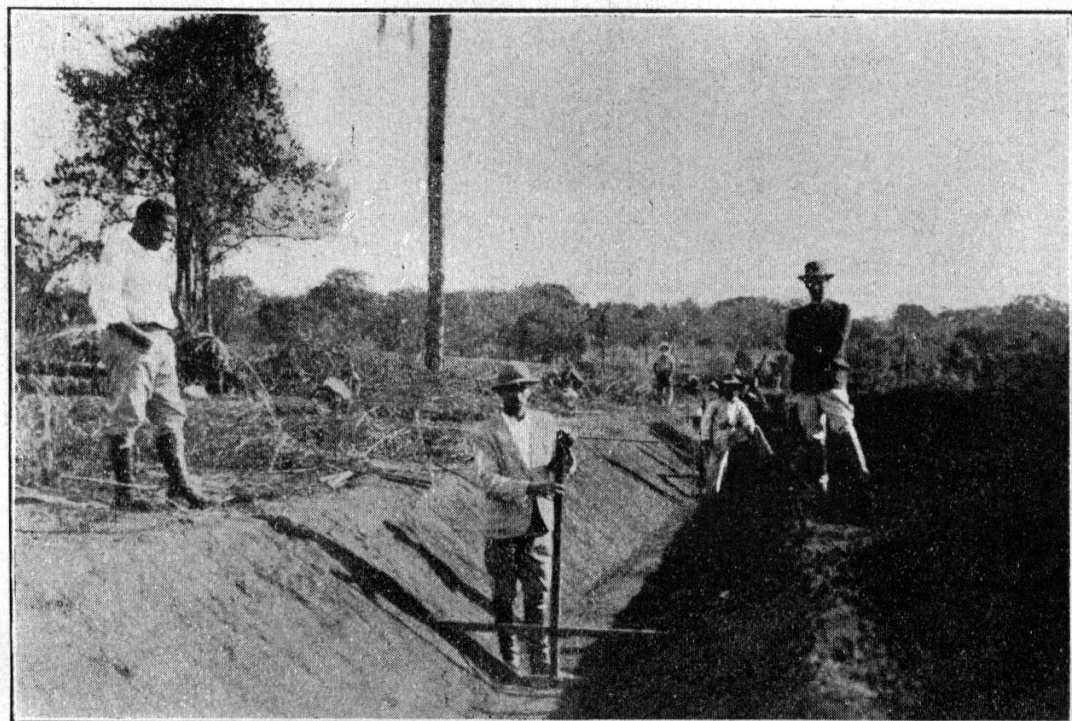
Fig. 15 — Parte do canal que servirá à horta e outras dependências' da Escola Prática de Agricultura, notando-se o pequeno molde de madeira que serviu para facilitar o acertamento da secção reta do canal.
