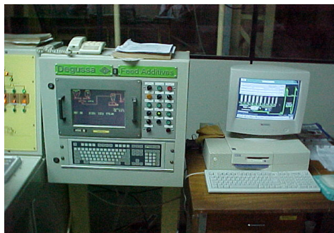
FIGURA 4. Sistema de controle de pesagem e dosagem automática dos ingredientes da ração.
