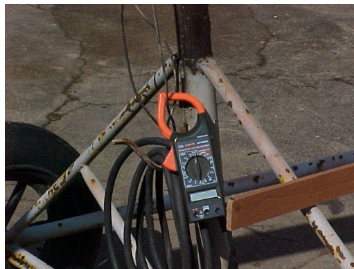
FIGURA 9. Medição da corrente elétrica de fase do motor elétrico.
