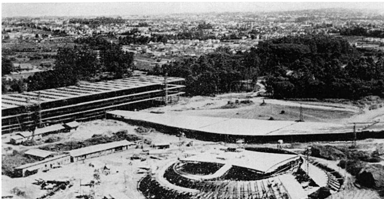
Figura 2 – Vista aérea da construção da marquise e pavilhões do Ibirapuera em 1953, em que se nota a substituição do bosque de eucaliptos pelo conjunto de edifícios. Fotografia de Boer, Copyright Casa Guilherme de Almeida, publicado em Instituto Cultural Itaú. Cadernos da cidade de São Paulo: Parque do Ibirapuera . São Paulo: ICI, 1997.
