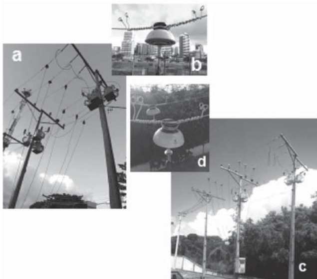
Figura 5: Fotos ilustrativas das redes energizadas para testes de agressividade ambiental sobre materiais da RDE, sendo: a) estação de Pituba, centro de Salvador, BA; b) detalhe de um isolador cerâmico com depósito de filme fino instalado; c) estação de Saúipe, BA; e d) detalhe de dois isoladores cerâmicos com e sem depósito de filme fino instalados [24].
