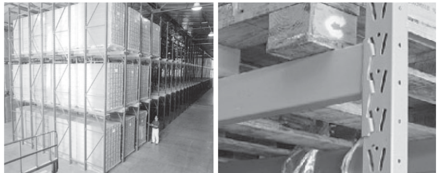
Figura 1 - Vista do rack e detalhe das ligações (Altamira [6] ).
