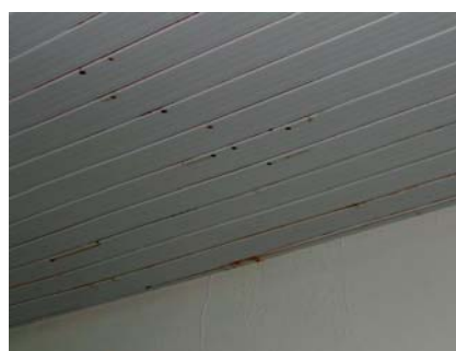
Figura 18 - Infiltração de água de chuva no forro de PVC.
