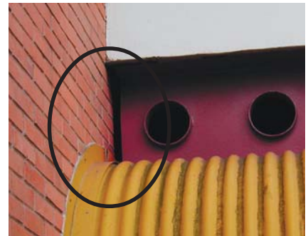
Figura 9 - Alvenaria desvinculada da estrutura.
