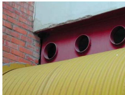
Figura 20 - Descascamento no contato estrutura-alvenaria.
