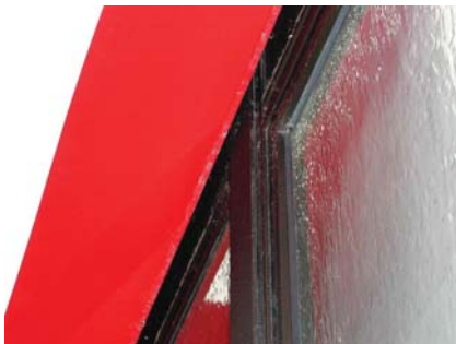
Figura 19 - Infiltração de água de chuva no contato estrutura-esquadria.
