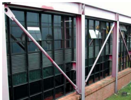
Figura 13 - Estado da pintura da estrutura metálica.
