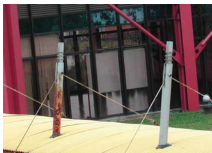
Figura 14 - Corrosão em peça da passarela.
