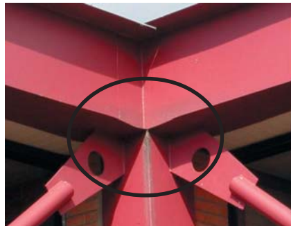
Figura 8 - Ondulação em viga.
