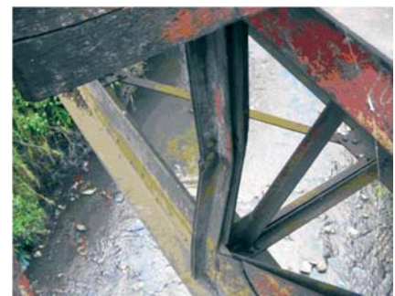
Figura 9 - Montante com flambagem global.
