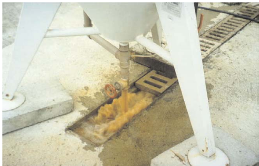
Figura 3 – Descarga de fundo do pré-filtro vertical de escoamento ascendente (PFVA 1234)
