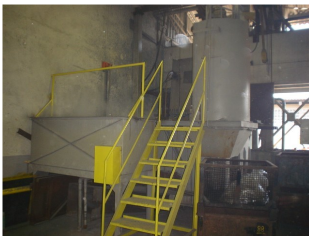
Figura 1: Linha Piloto de Galvanização
