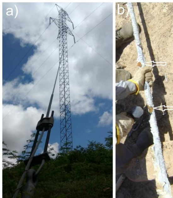
Figura 1: Fotos ilustrativas: (a) de uma das torres estaiadas de uma linha de transmissão de energia elétrica instalada no nordeste do Brasil; (b) do problema de corrosão em determinadas regiões (setas) de uma das hastes enterradas por cerca de 10 anos.
