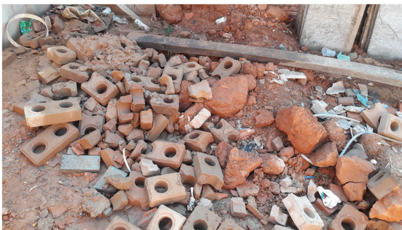
Figura 5: Tijolos quebrados e danificados na obra.
