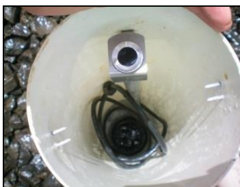
Figura 11 - Medidor de nível instalado no interior do poço de monitoramento, constituído por tubo de PVC utilizado para coleta de dados de nível de água no interior do poço
