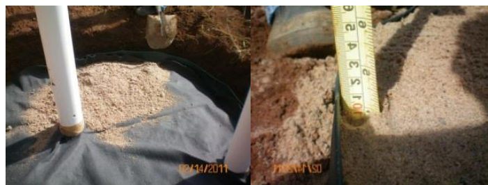
Figura 7 - Camada de 10 cm de areia colocada em cima da tampa de metal sobre a manta geotêxtil na construção do poço de infiltração
