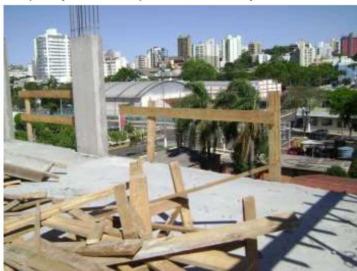
Figura 2- Inexistência de proteção eficaz na periferia da edificação
