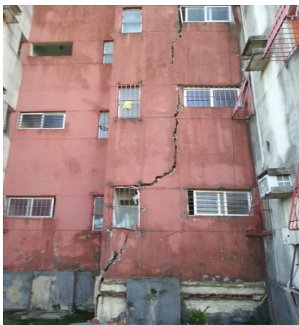
Figura 3 - Vista lateral do Residencial Eldorado após o colapso
