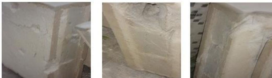
Figura 18 - Ruptura dos prismas com reforço de argamassa com tela de aço: prismas distintos
