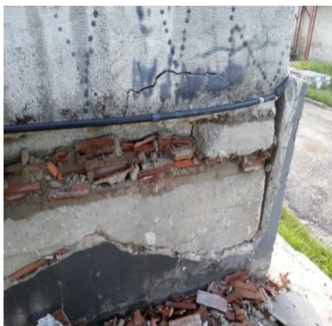
Figura 4 - Detalhe do esmagamento da alvenaria entre a viga de fundação e a laje de piso do térreo
