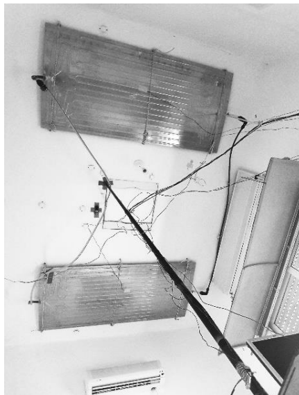
Figura 3 - Teto da sala TR, mostrando os painéis radiantes
