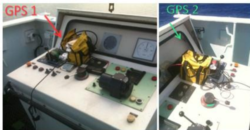
Figura 3: Painéis externos de comando (esquerda e direita) sobre os quais foram instalados os receptores
