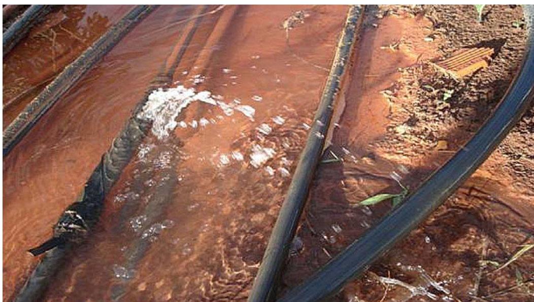
Foto 1. Vista Parcial de ligações clandestinas de água em área de expansão/ocupação urbana vizinha ao Jardim Ana Carla em Rondonópolis - MT, inclusive com ocorrência de um vazamento
