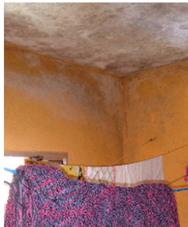
Figura 10 – Casa 18, mofo nas paredes e lajes persiste mesmo com a construção do segundo pavimento
