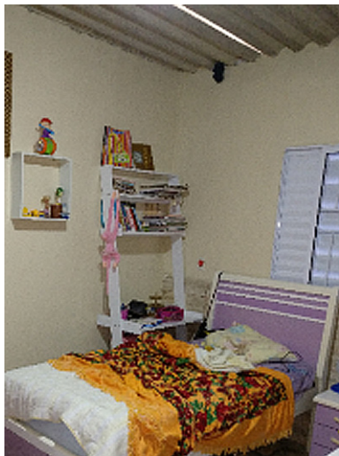
Figura 9 – Casa 18, o telhado de fibrocimento na ampliação da casa deixa fenda de luz visível
