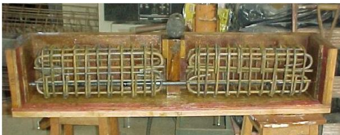
Figura 5 - Detalhe da armadura posicionada no interior das formas de madeira, instantes antes da concretagem
