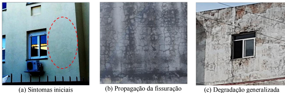
Figura 1 - Exemplo das etapas evolutivas da degradação por fissuração
