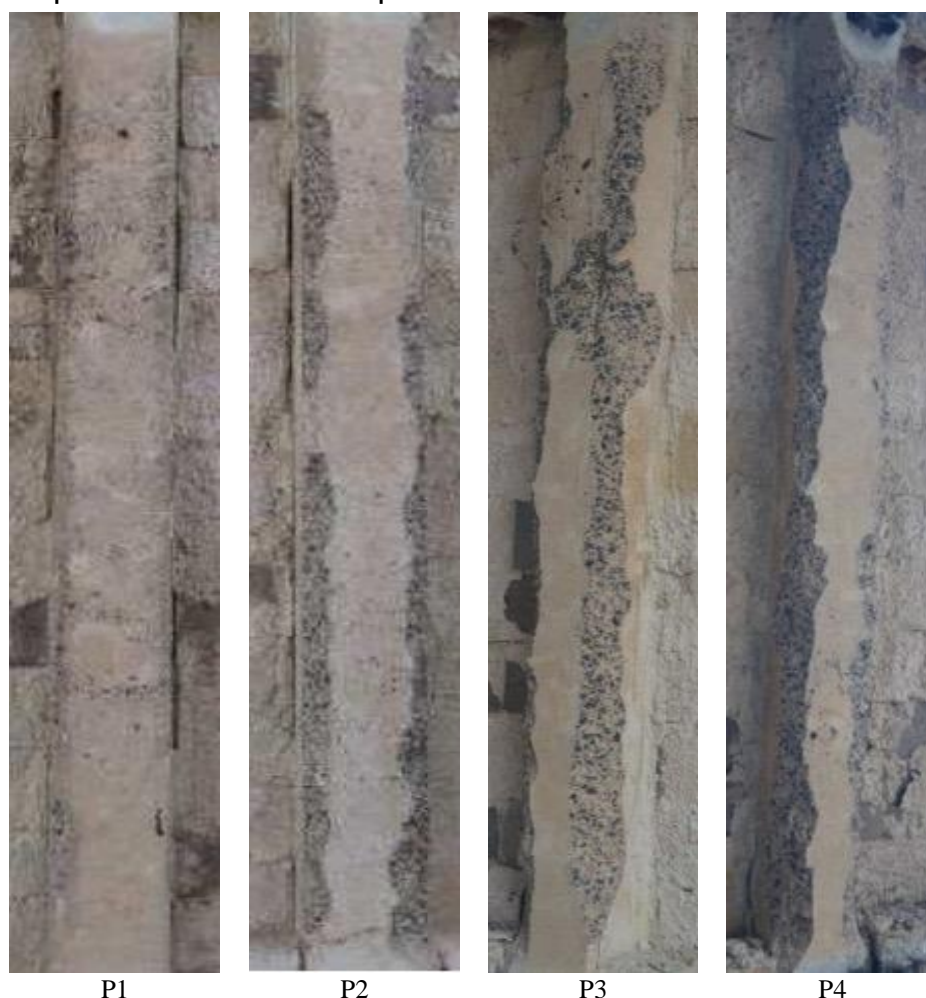
Figura 12 - Deslocamento do concreto nos pilares
