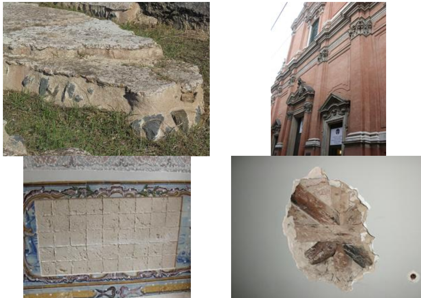
Figura 1 - Argamassas de cal de edifícios históricos: argamassas de pavimento da Villa romana de Pisões; revestimento de Igreja em Bolonha; assentamento de painel de azulejos em parede interior de um Palácio da região de Lisboa; parede de edifício com gaiola Pombalina, na Baixa de Lisboa
