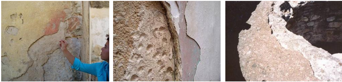
Figura 2 - Revestimentos antigos multicamada
