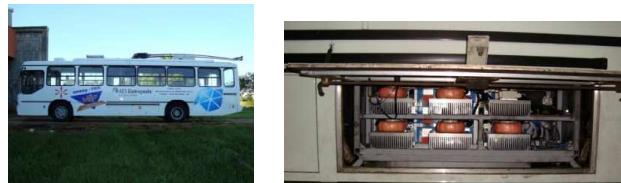
Figura 17: (a) Trólebus utilizado para os Testes de Campo; (b) Conversor proposto de 150kW instalado no Trólebus.
