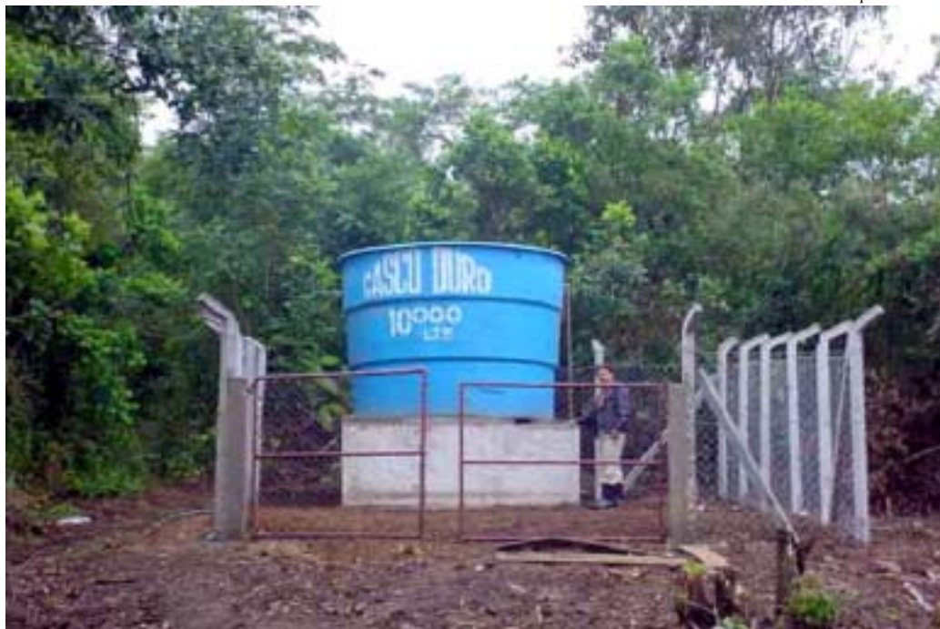
Reservatório de dez mil litros colocado pela Funasa-SP.
