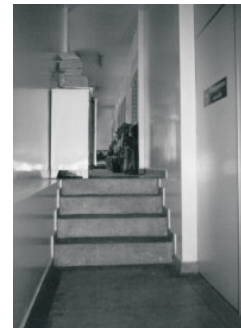
Escada interna com degraus muito altos e hall parcialmente obstruído
