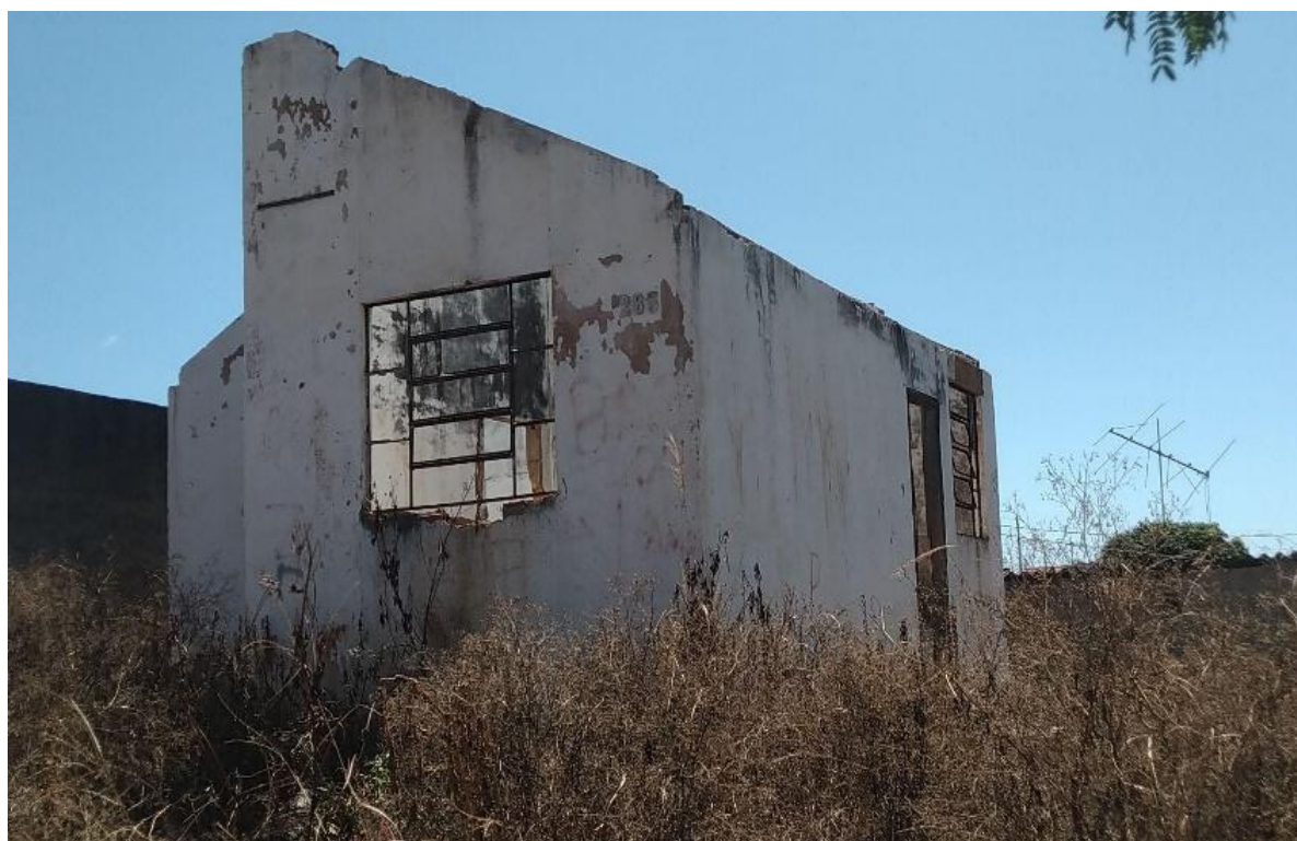
Foto 1 - Fachada e lateral do imóvel do conjunto habitacional, 2022
