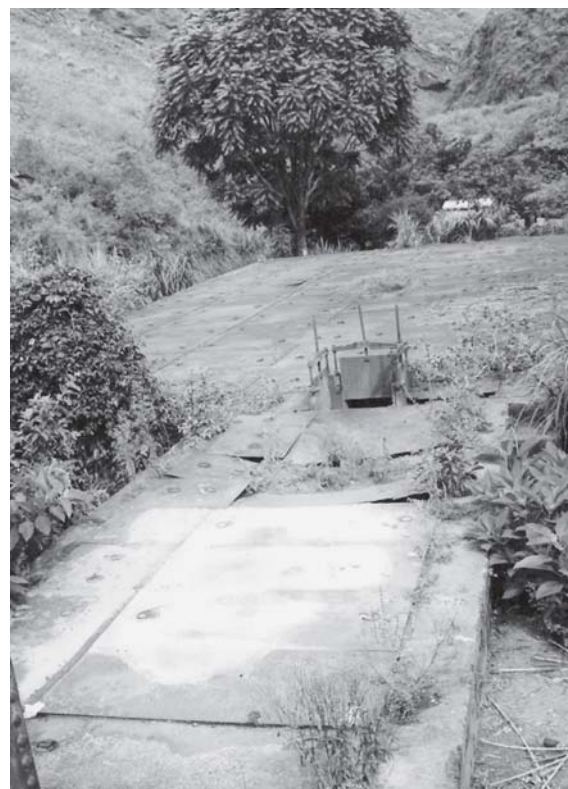
Figura 3: Tanques de Desinfecção da Barra. Foto Alberto Fonseca, 2005
