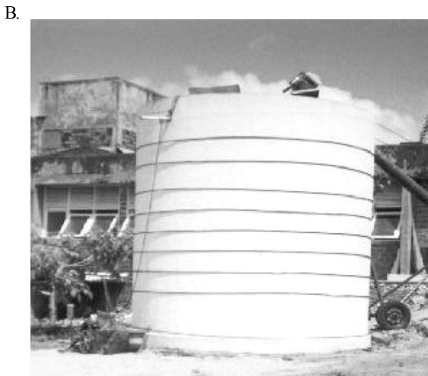
Silo com cintas metálicas
