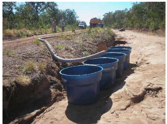
Figura 3. Equipamento instalado na estrada Doverlândia-Baliza, no município de Baliza, GO, mostrando a estrada deslocada de seu eixo original devido ao alto índice de erosão
