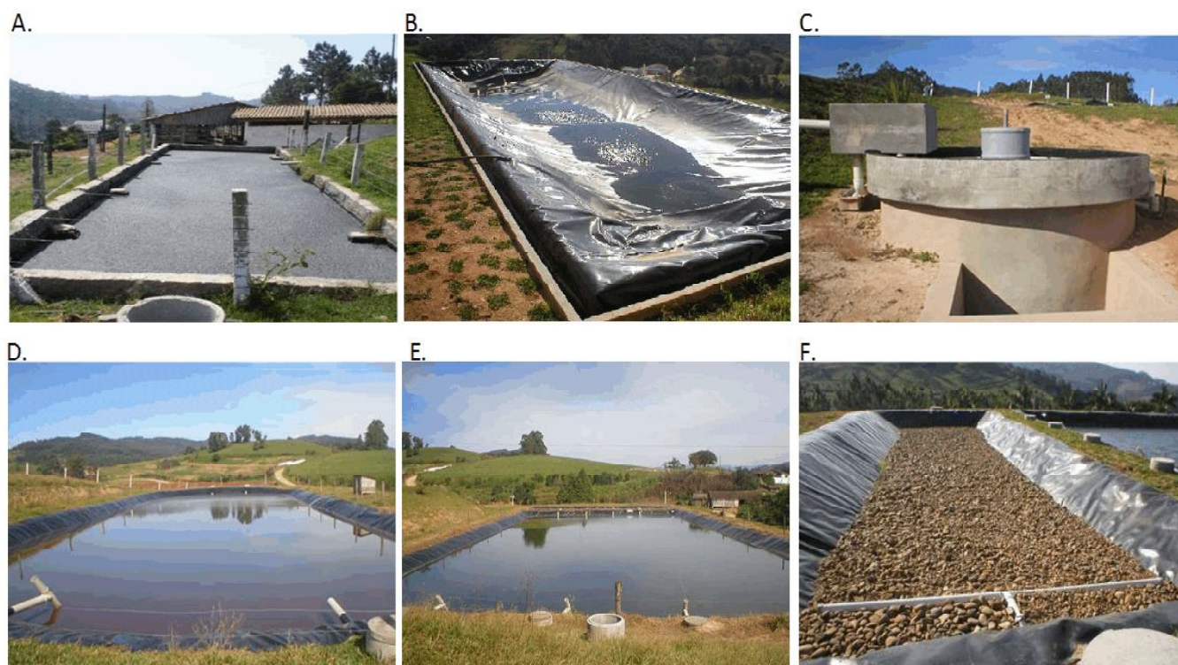
Figura 2. Unidades de tratamento da estação experimental: Lagoa de decantação (A); Lagoa anaeróbia (B); Reator UASB (C); Lagoa facultativa aerada (D); Lagoa de maturação (E); Filtro de pedras (F)
