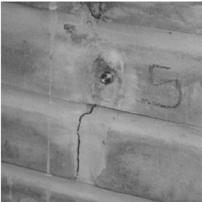
Figura 7. Painel, mostrando a ocorrência de fissuras
