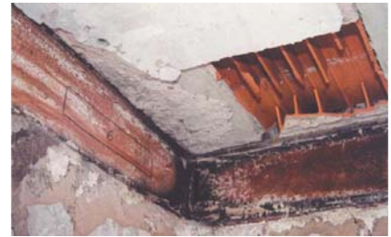
Figura 5 - Detalhe das lajotas cerâmicas danificadas.
