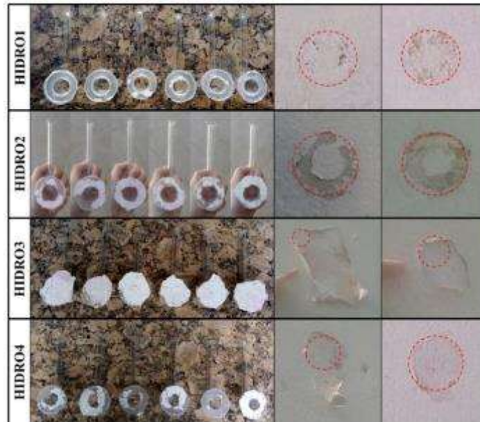
Figura 6: Destacamento da pintura pela retirada dos cachimbos.
