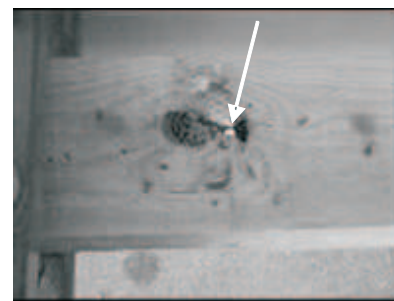
Ruptura no nó
